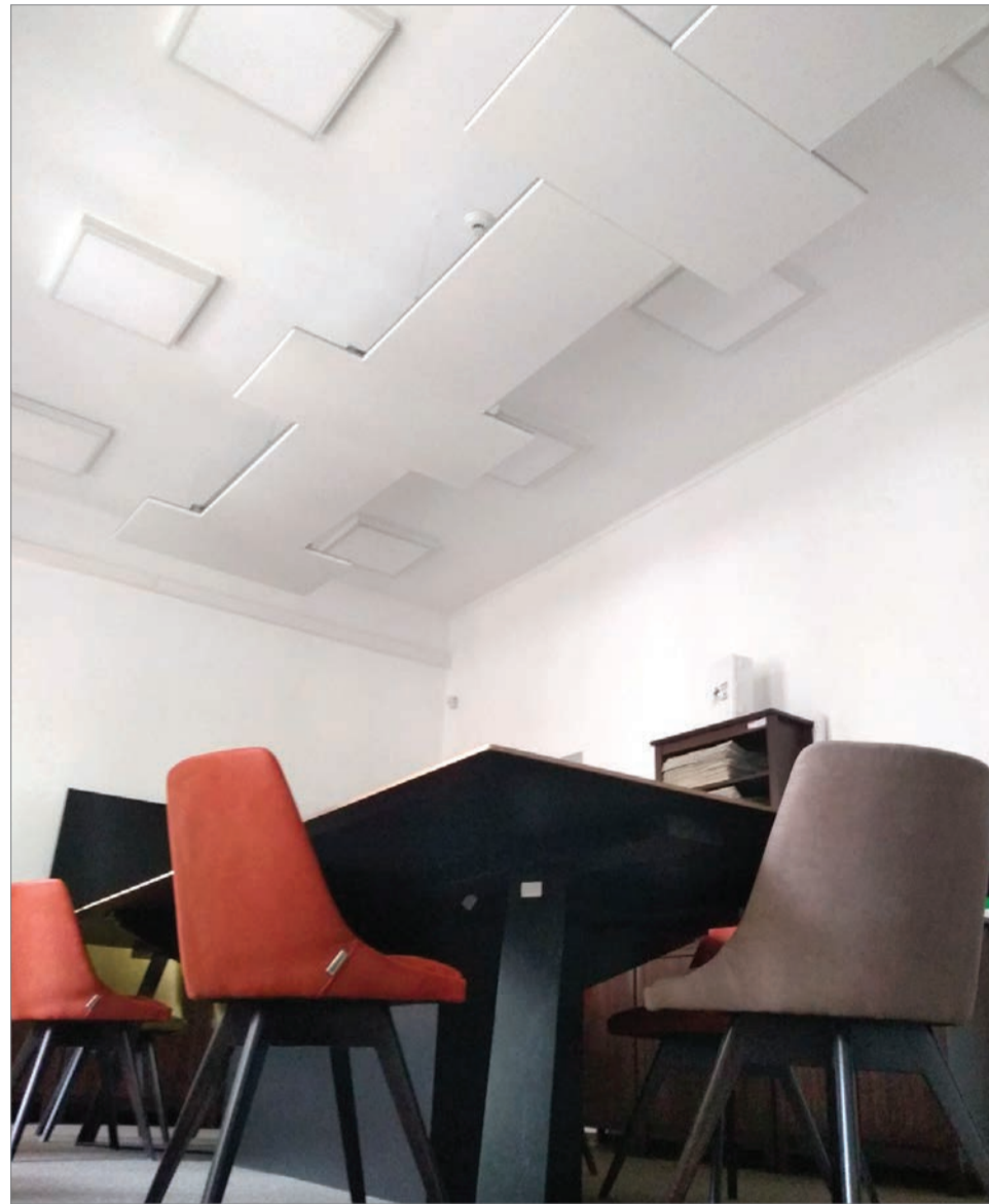
Egyre közkedveltebbek a közvetlenül a helyiséget fűtő elektromos infrapanelek is
