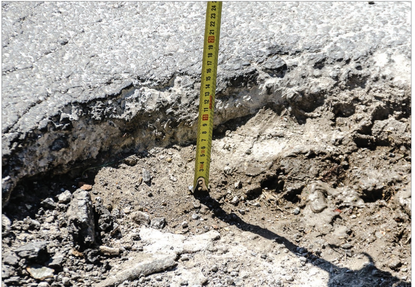
A betonréteget ért a mély gödör az úttesten. Csapdahelyzet
